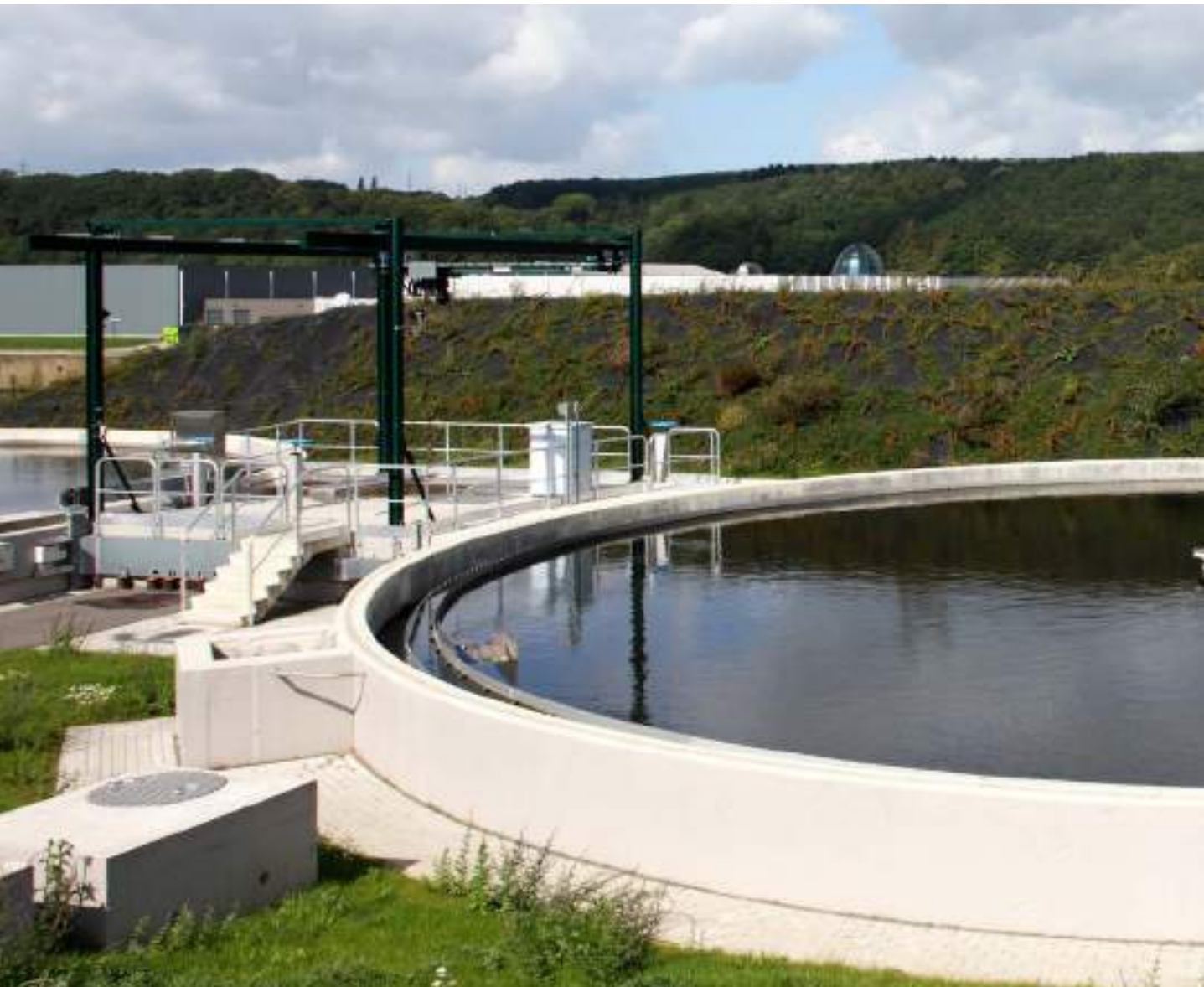
Andenne // Décanteur secondaire
