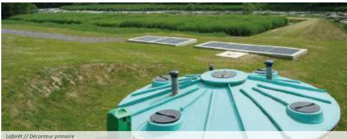
Laforêt // Décanteur primaire
