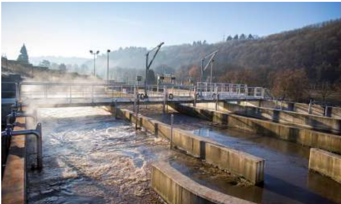
Station d'épuration de Dinant // Bassins d'activation
