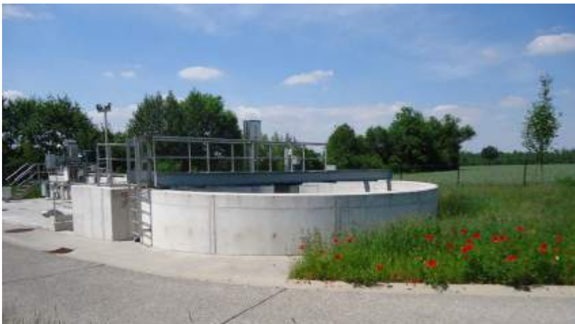
Pontillas (Gochenée) // Station d'épuration
