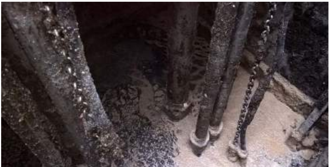
Andenne // Graisses rejetées anormalement dans un pompage du réseau
