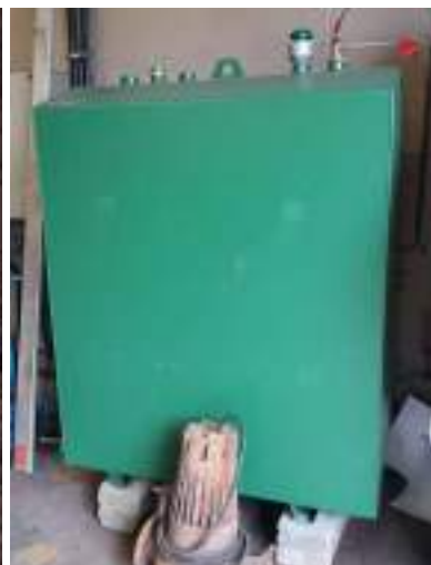
Rochefort // Cuve à mazout avec double encuvement sécurité en cas de fuite
