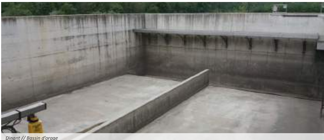
Dinant // Bassin d'orage
