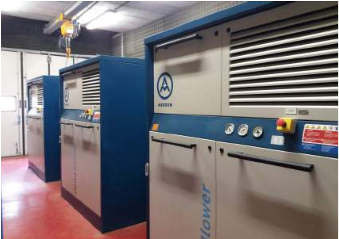
Wépion // Surpresseurs (principale source de consommation d'énergie pour l'aération des bassins d'activation)
