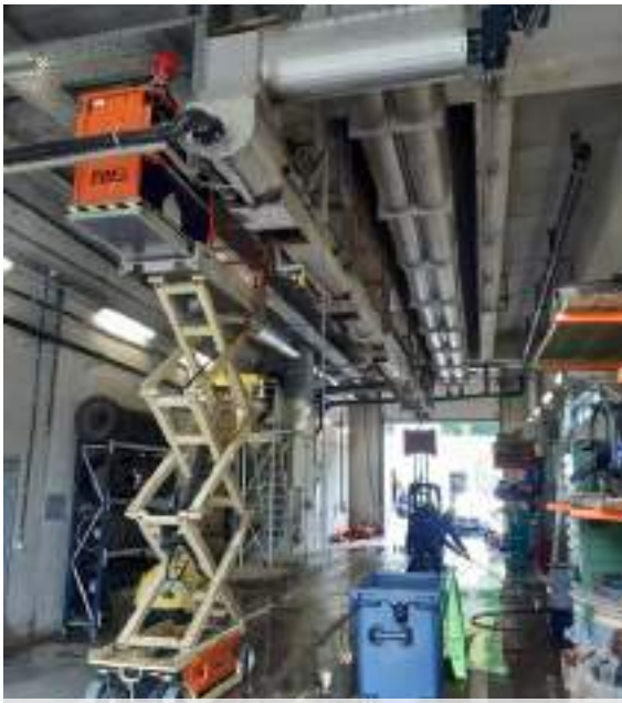
Lives // Travail en hauteur : remplacement du revêtement d'usure de la vis à boues
