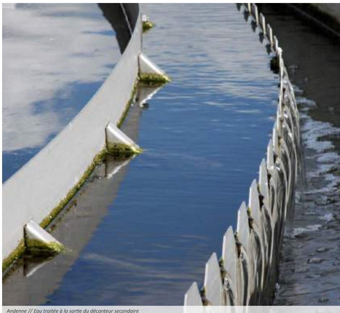
Andenne // Eau traitée à la sortie du décanteur secondaire
