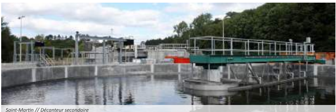
Saint-Martin // Décanteur secondaire
