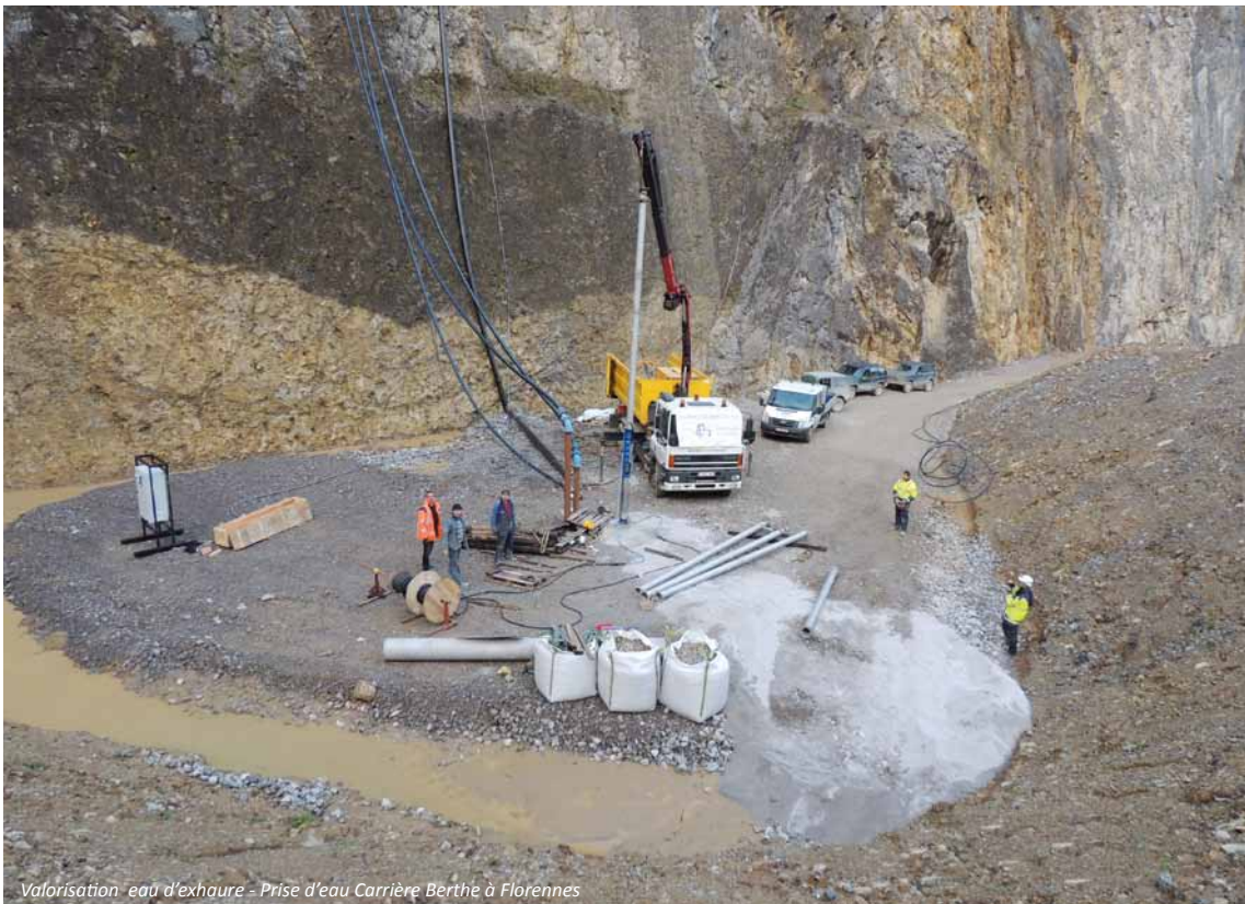
Valorisation eau d'exhaure - Prise d'eau Carrière Berthe à Florennes
