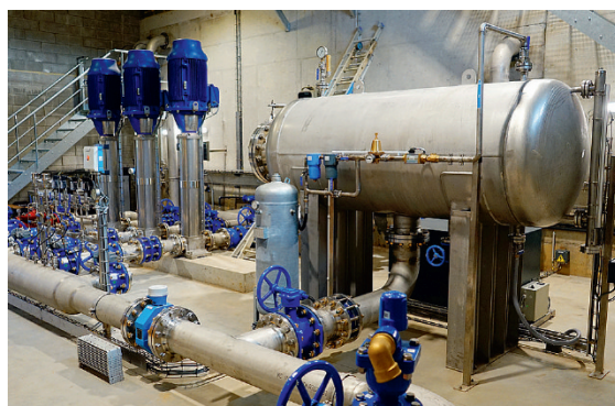
Les installations permettant d'assurer l'approvisionnement.
